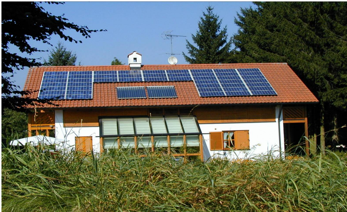
5,4 KWp-Anlage Solar-Fabrik Freiburg
