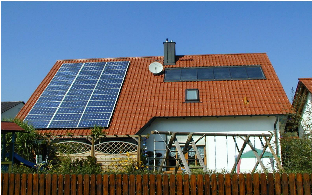
4,14 KWp-Anlage Solar-Fabrik Freiburg
